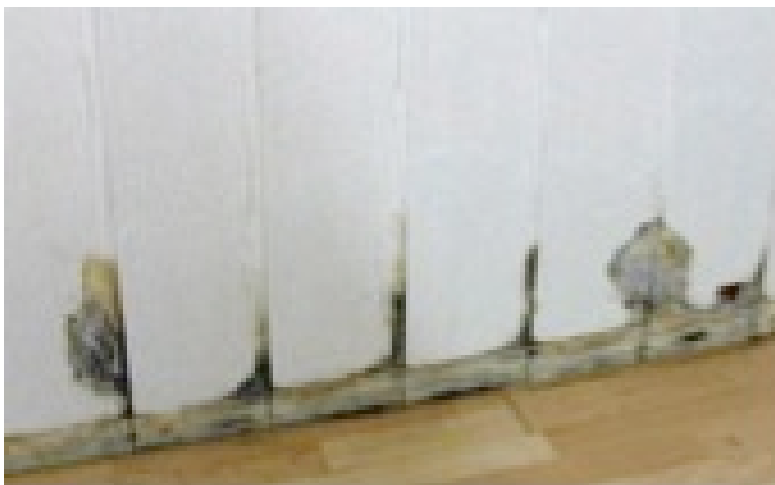
Massiver Schimmelbefall im feuchten Bereich einer Wandverkleidung
