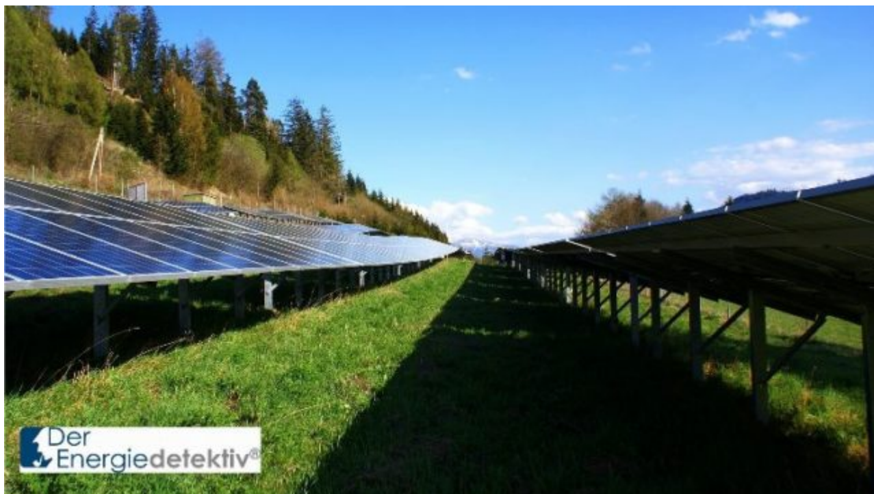
Photovoltaikanlage (PVA) in den steirischen Bergen: Licht und Schatten lassen jedermann die Umverteilung im solaren Versorgungsprozess erkennen.
