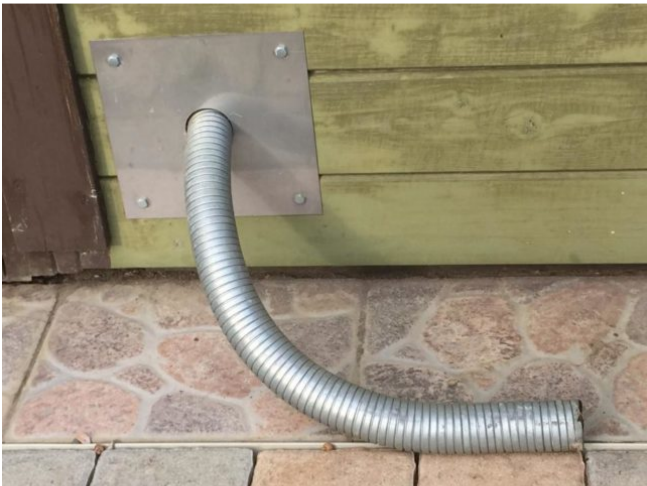
Bild 24: Durchleitung der Abgase eines Dieselaggregats durch eine Laubenwand mittels flexiblem Edelstahl-Abgasschlauch
