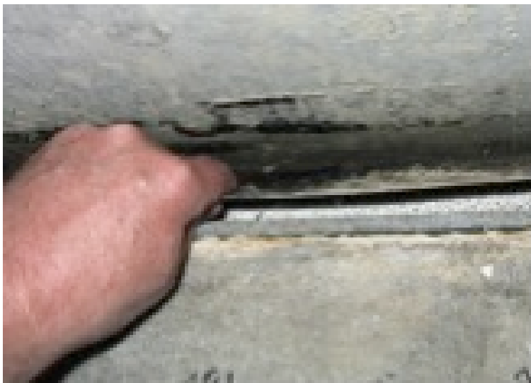
Schwarzer Schimmel auf Beton
