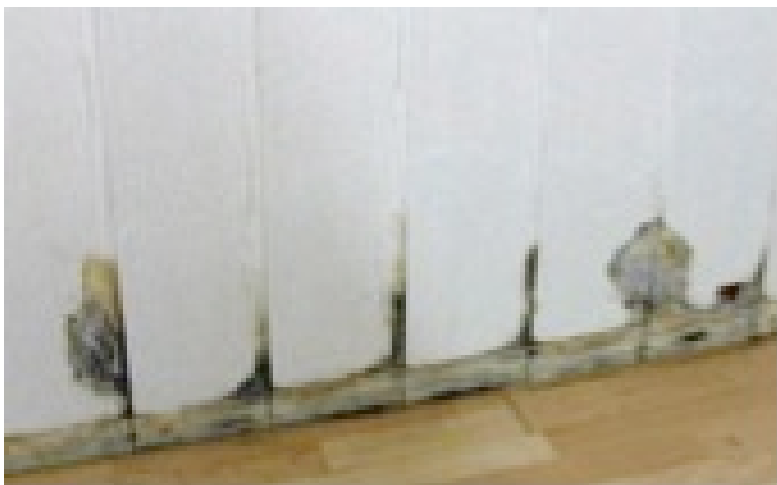
Massiver Schimmelbefall im feuchten Bereich einer Wandverkleidung
