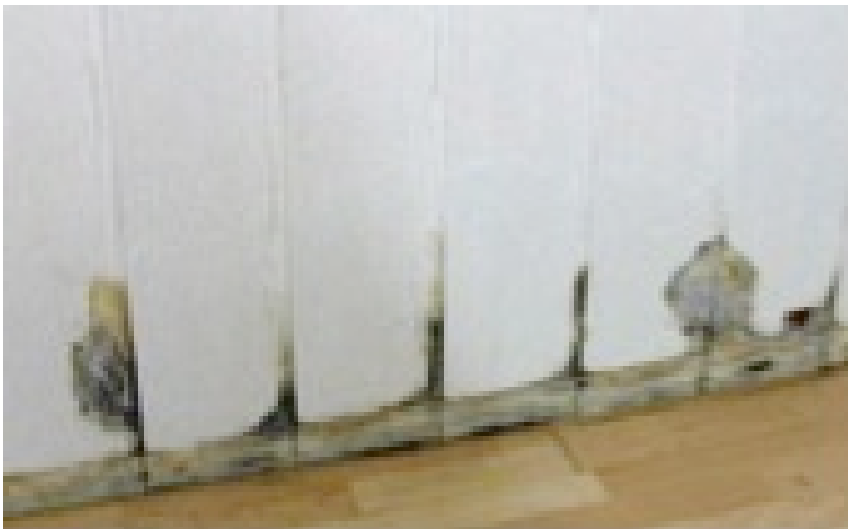
Massiver Schimmelbefall im feuchten Bereich einer Wandverkleidung
