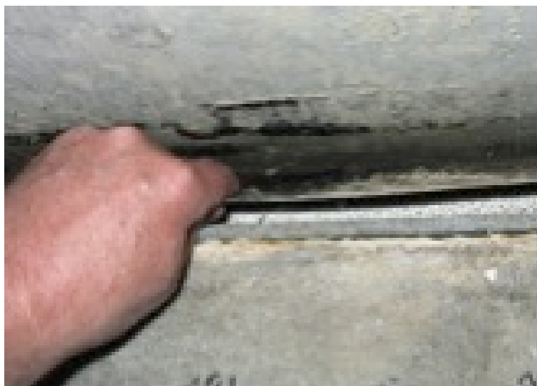
Schwarzer Schimmel auf Beton
